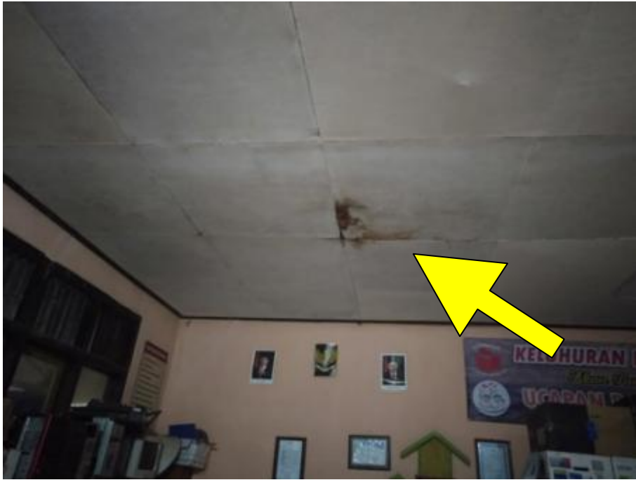
Plafon ruangan jebol
