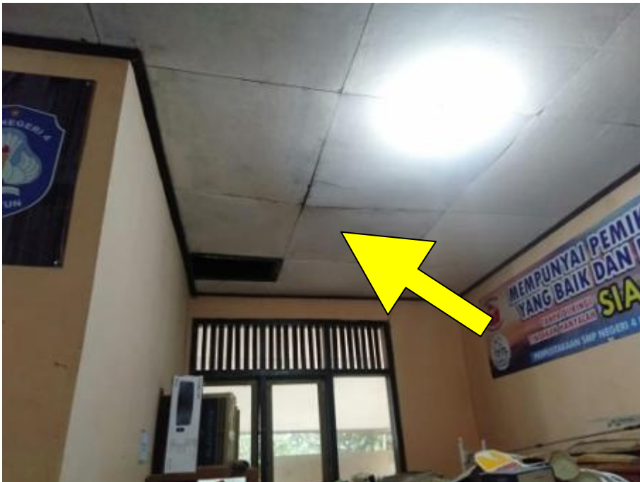
Plafon ruangan jebol
