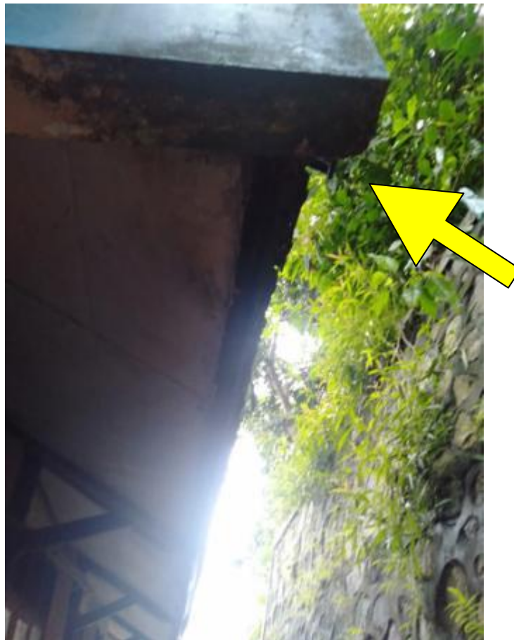
Plafon belakang rusak
