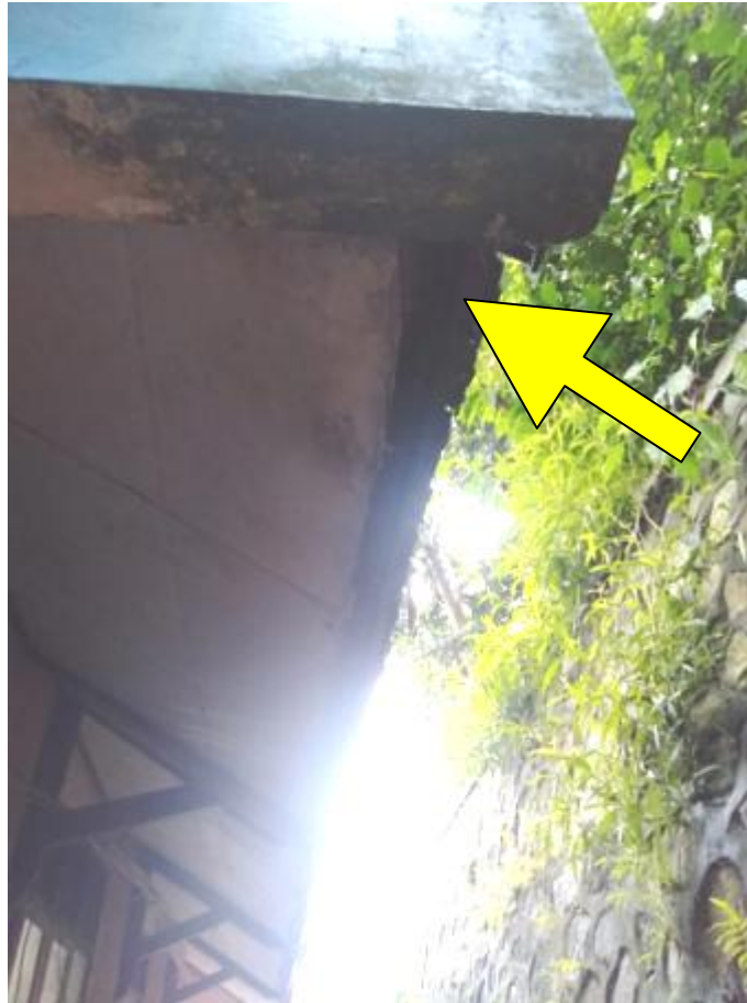
Plafon teras belakang rusak dan bocor
