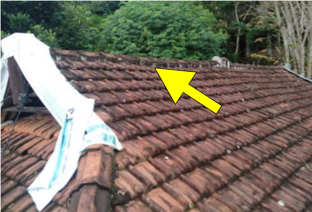
Atap perpustakaan mulai melengkung akibat kap yang mulai rapuh
