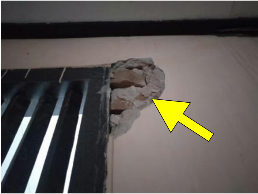
Kusen pintu perpustakaan mulai rusak
