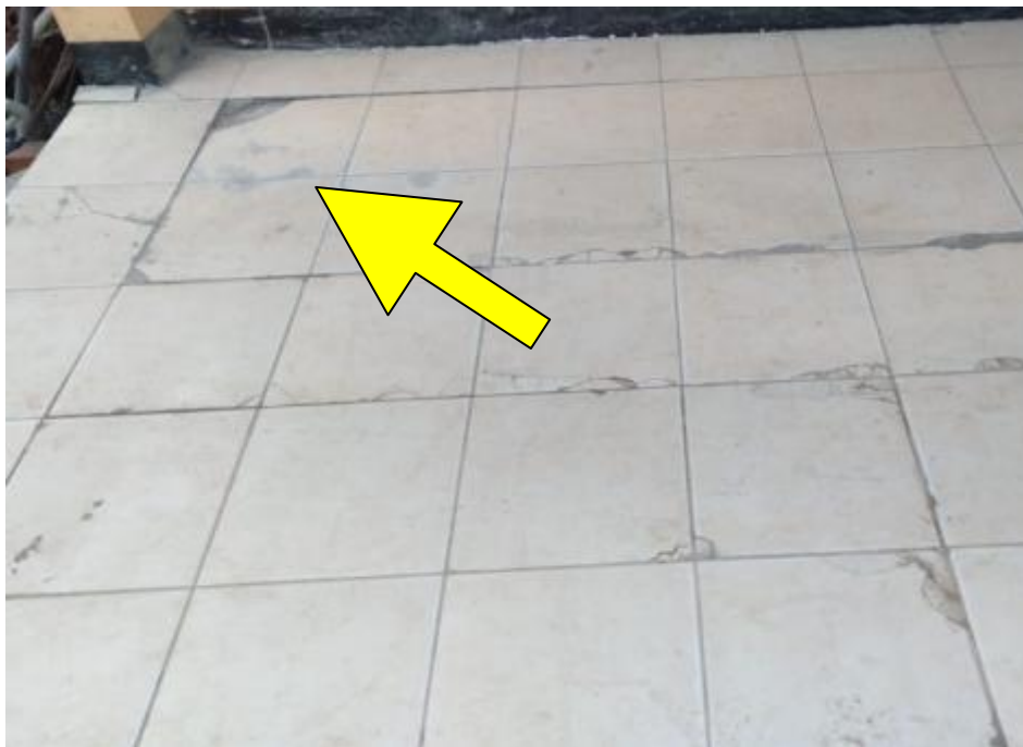
Lantai teras perpustakaan pecah dan amblas
