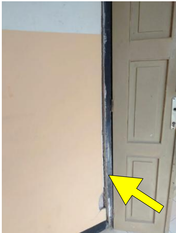
Kusen pintu perpustakaan rapuh dan rusak
