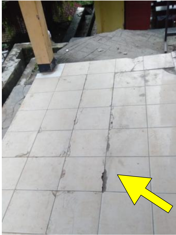
Lantai teras perpustakaan pecah dan amblas
