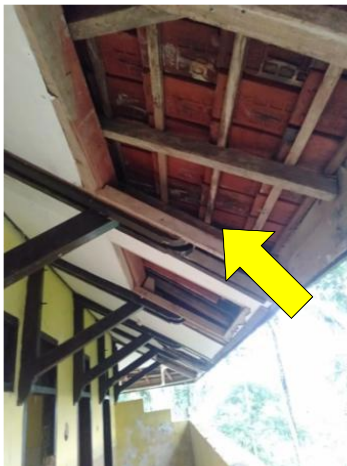
Plafon teras WC rusak
