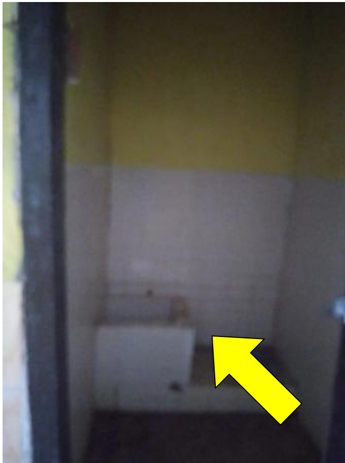
Kamar mandi tidak berfungsi
