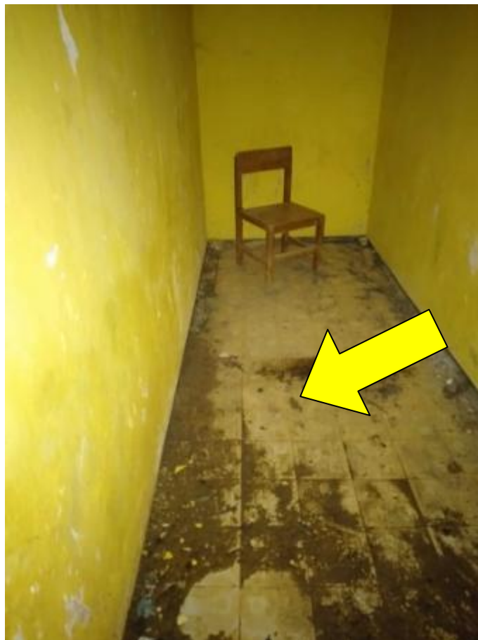
Lantai kamar ganti ambles
