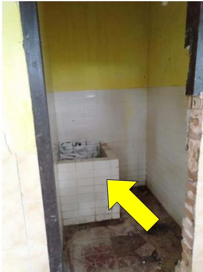
Bak mandi tidak berfungsi
