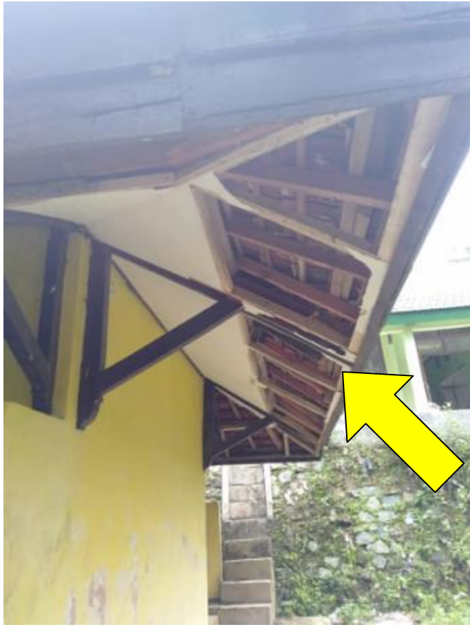
Plafon teras WC rusak
