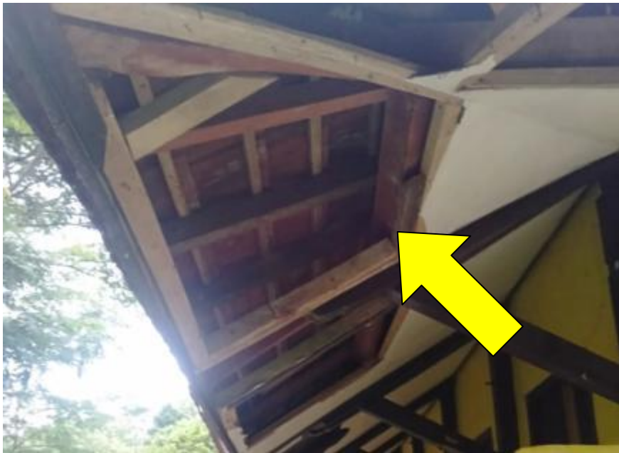
Plafon teras WC rusak
