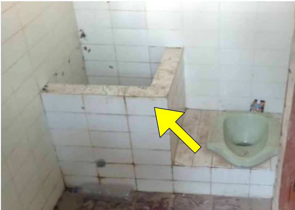
Kamar mandi tidak berfungsi
