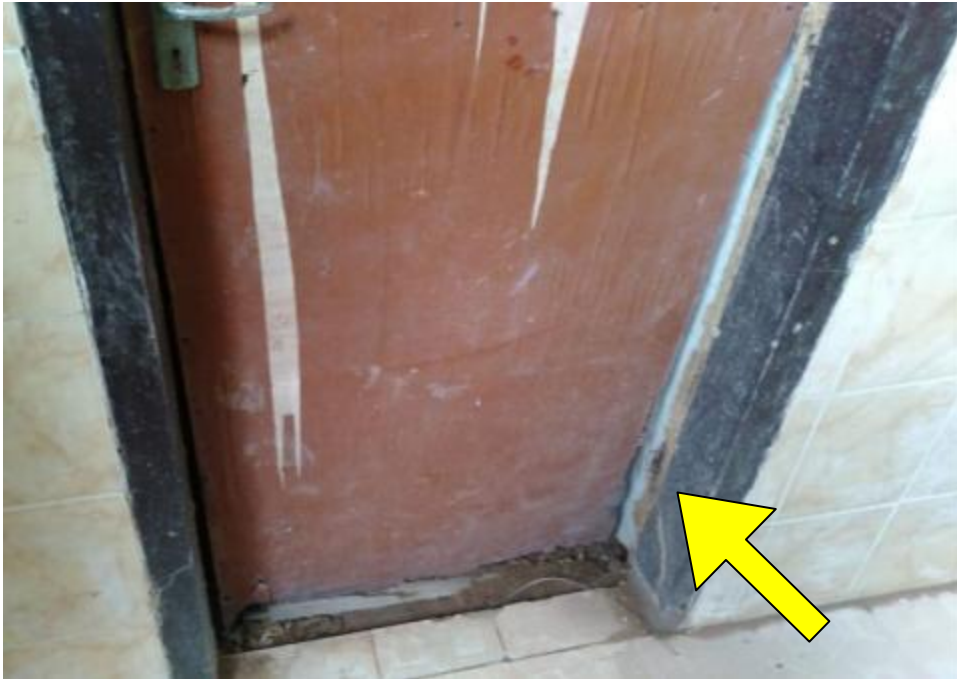
Pintu rusak lepas
