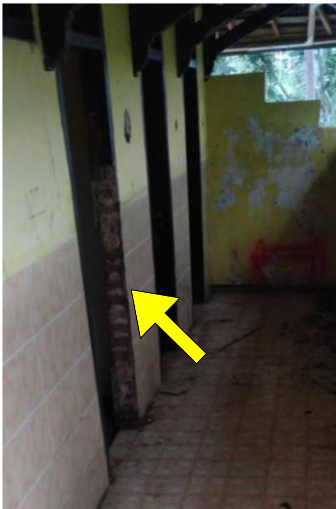
Kusen pintu WC rusak
