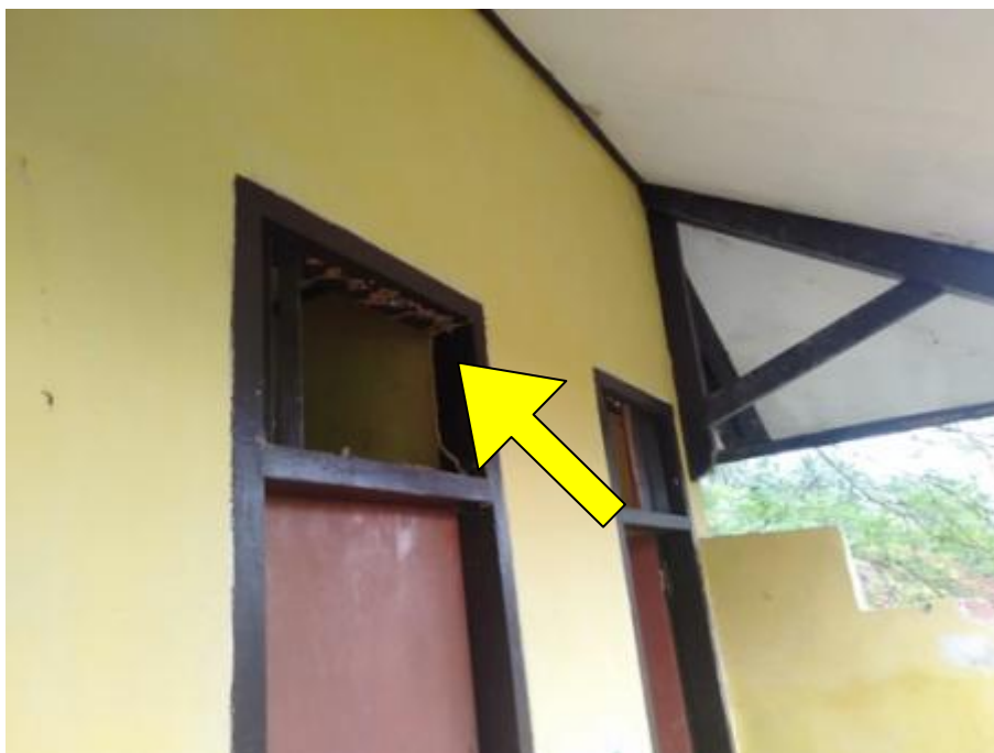
Ventilasi WC siswa rusak
