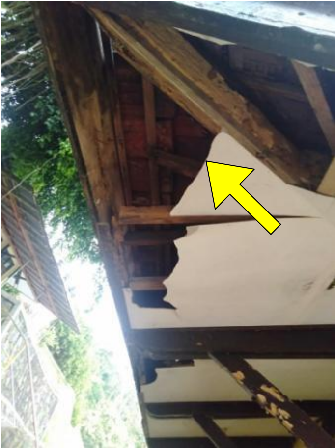
Plafon teras rusak
