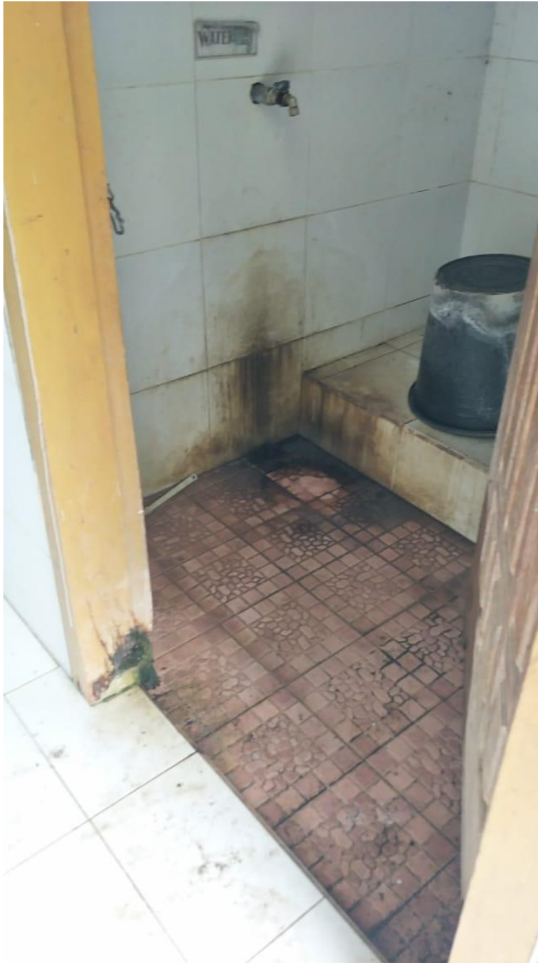
Keramik berkerak dan gawang rusak
