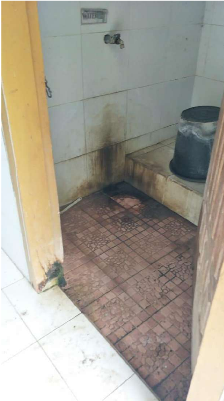
Keramik berkerak dan gawang rusak
