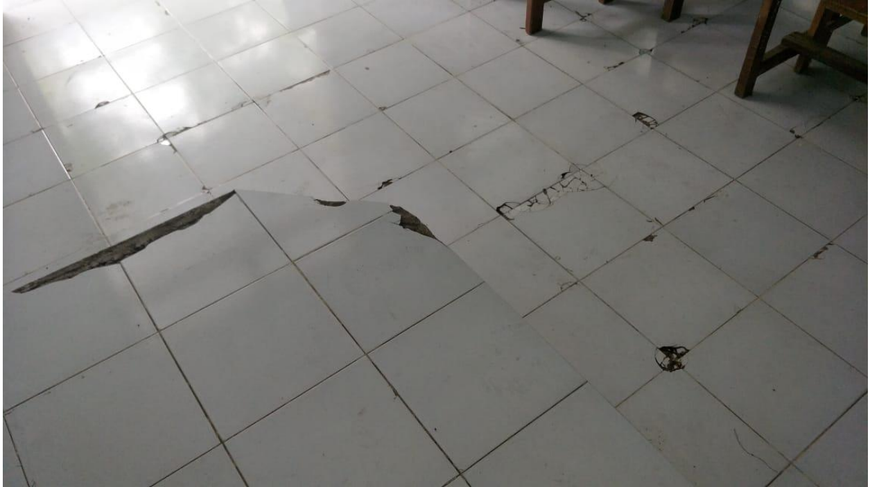
LANTAI AMBLAS DAN PECAH
