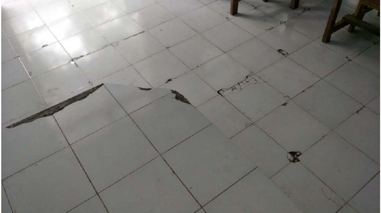
LANTAI AMBLAS DAN PECAH
